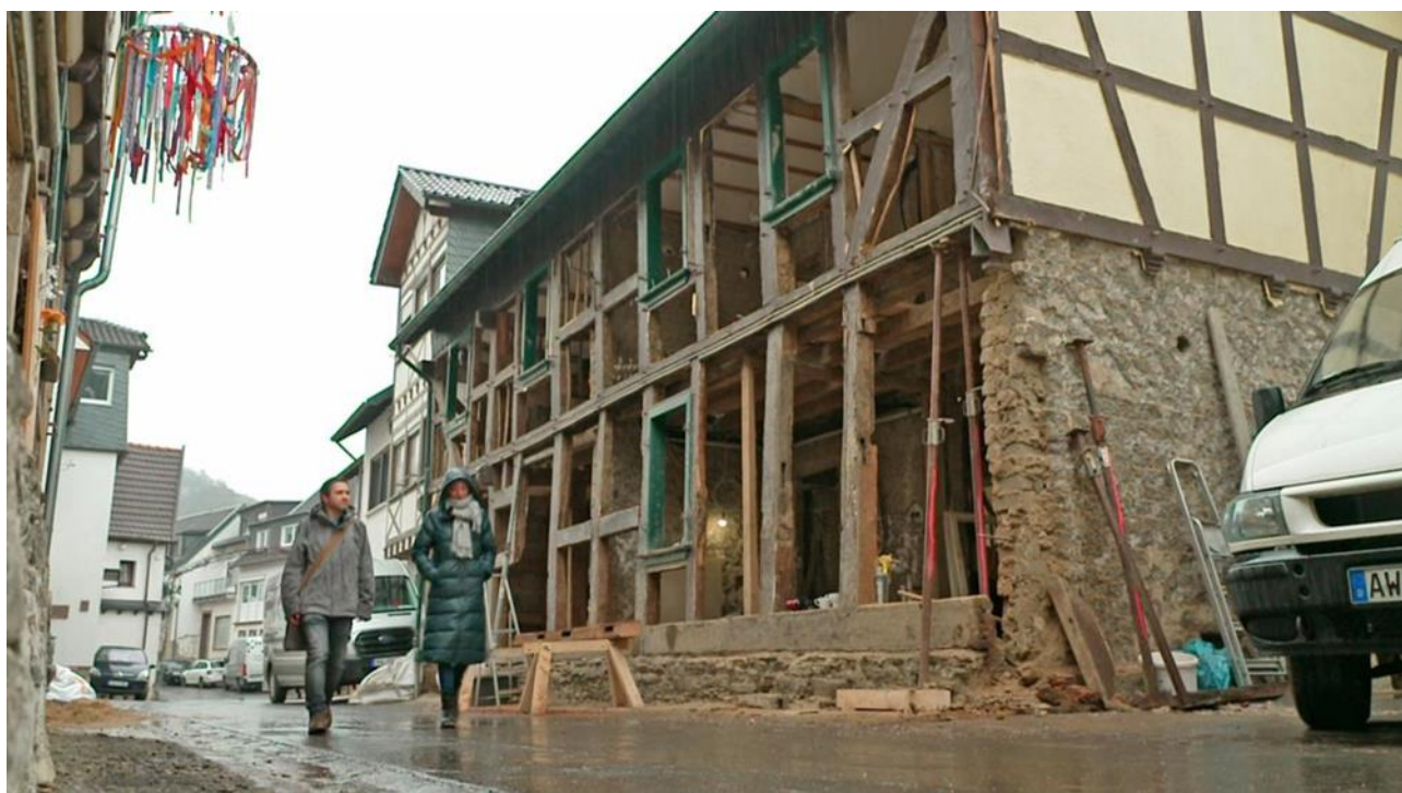
Zerstörtes Gebäude nach der Flutkatastrophe im Ahrtal, "Neue Fehler beim Wiederaufbau?", Sendung vom Di 17.05.22 um 21:45, Der Wiederaufbau kommt im Ahrtal nur schleppend voran, Foto (c) Bild: SWR" (S2+)
