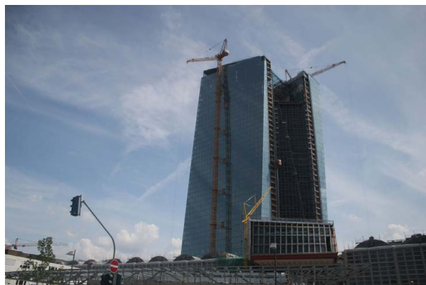
EZB-Neubau an der früheren Großmarkthalle im Frankfurter Ostend. Der Umzug in das neue Gebäude ist für 2014 geplant. Aufgenommen am 18. Juli 2013. Foto: © Kulturrexpress
