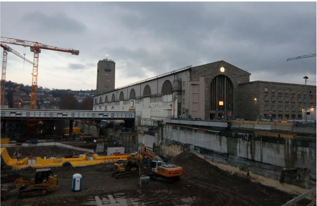
Tiefbaustelle vor dem Stuttgarter Hauptbahnhof mit historischem Portalhaus von Paul Bonatz, aufgenommen am 02. Februar 2019 abends, Foto (c) Kulturrexpress
