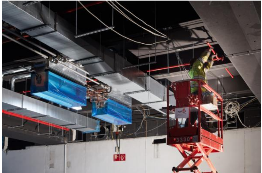
Deckeninstallationen in Halle 6, Foto (c) Jean-Luc Valentin
