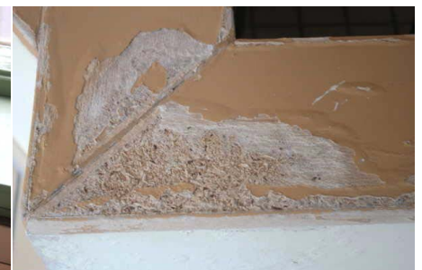
Von der Salzlucht lädierte Abdeckungsschicht auf einer Brüstung mit Handlauf
