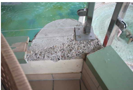
Durch den Salzeinfluss marodierte Unterzüge zur Befestigung von Geländerstützen aus Metall
