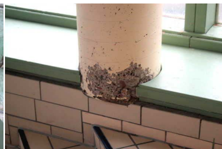
Vom Salzfraß betroffene Gebäudestützen
