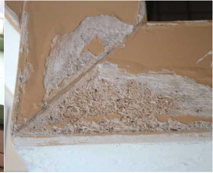
Von der Salzluft lädierte Abdeckungsschicht auf einer Brüstung mit Handlauf
