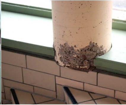
Vom Salzfraß betroffene Gebäudestützen
