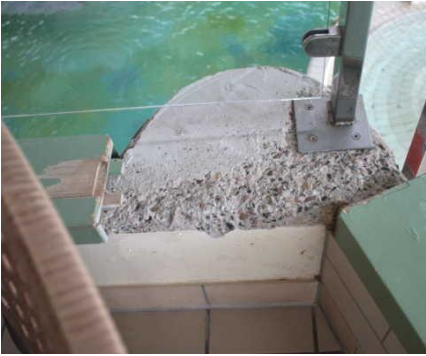
Durch den Salzeinfluss marodierte Unterzüge zur Befestigung von Geländerstützen aus Metall
