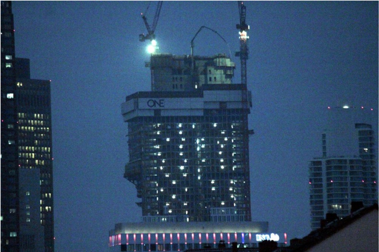
Das ONE ist ein in Bau befindliches Hochhaus im Europaviertel in Frankfurt, Stand: Dezember 2020, abends
