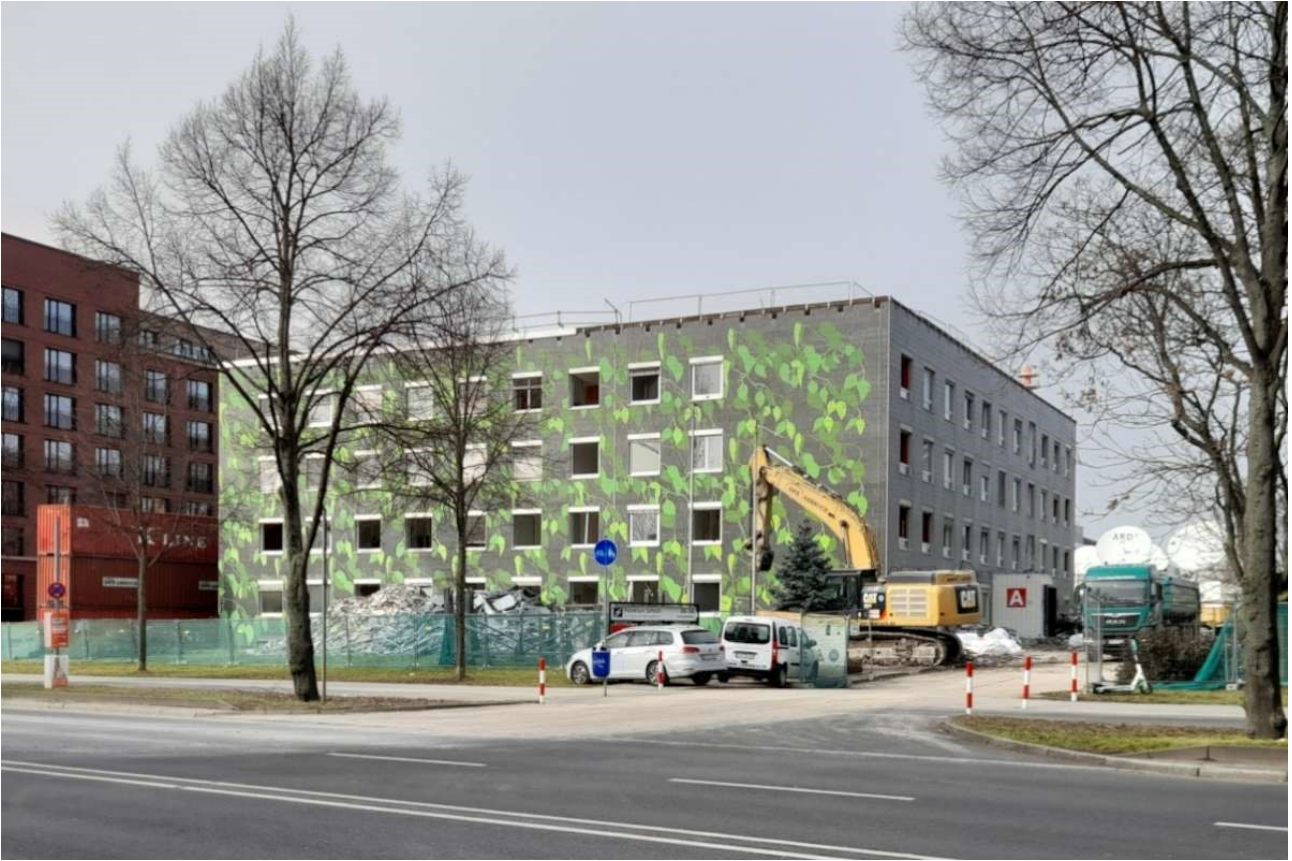
Sanierungsfall ehemaliges Arbeitsgericht in Frankfurt am Main, Februar 2021
